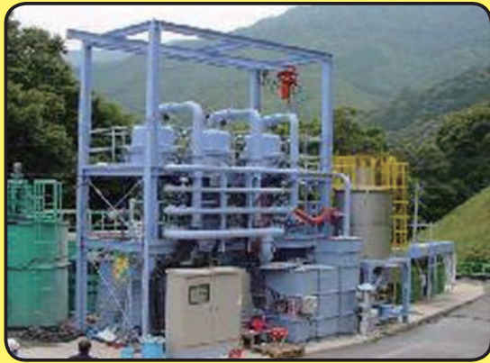
トンネル工事濁水：100m 3 /hr モノMAXユニット1200A × 3基
