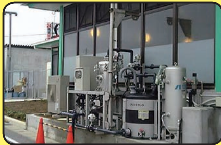
浴槽水：20m 3 /hr モノMAXユニット450A
