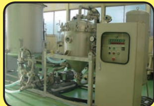
化学工場排水：20m 3 /hr モノMAXユニット700A
